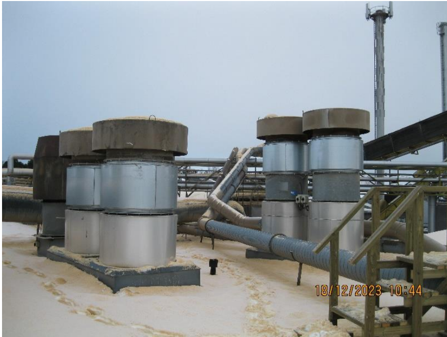
Kuva 136. Äänilähde 128. Vaneritehtaan puhaltimet. Äänenvaimentimet asennettu.
