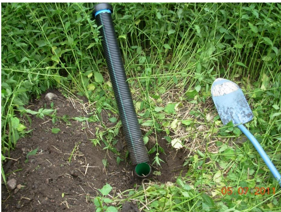
Kuva 32. Katkennut kaasuntarkkailuputki 2 vuonna 2011
